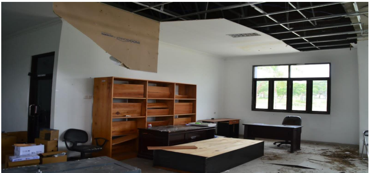
Ruangan Pustakawan ( Susudah Gempa )
