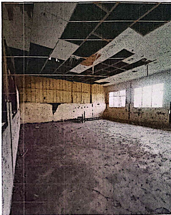
Kelas yang rusak
